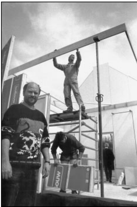
Ir. Faas Moonen ontwikkelde een supersnelle bouwwijze met behulp van dakplaten. Foto: Bart van Overbeek
