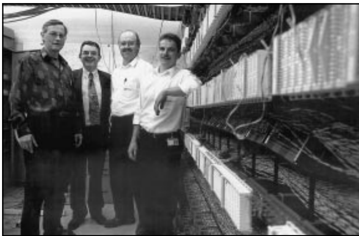
Vlnr: Joop Schillemans, Jan Geurts, Henri Timmers en Jan van Hoof, staand bij de hoofdverdeler van de centrale in het hoofdgebouw, zien de afloop van TUE-day met spanning tegemoet. Foto: Bart van Overbeke
